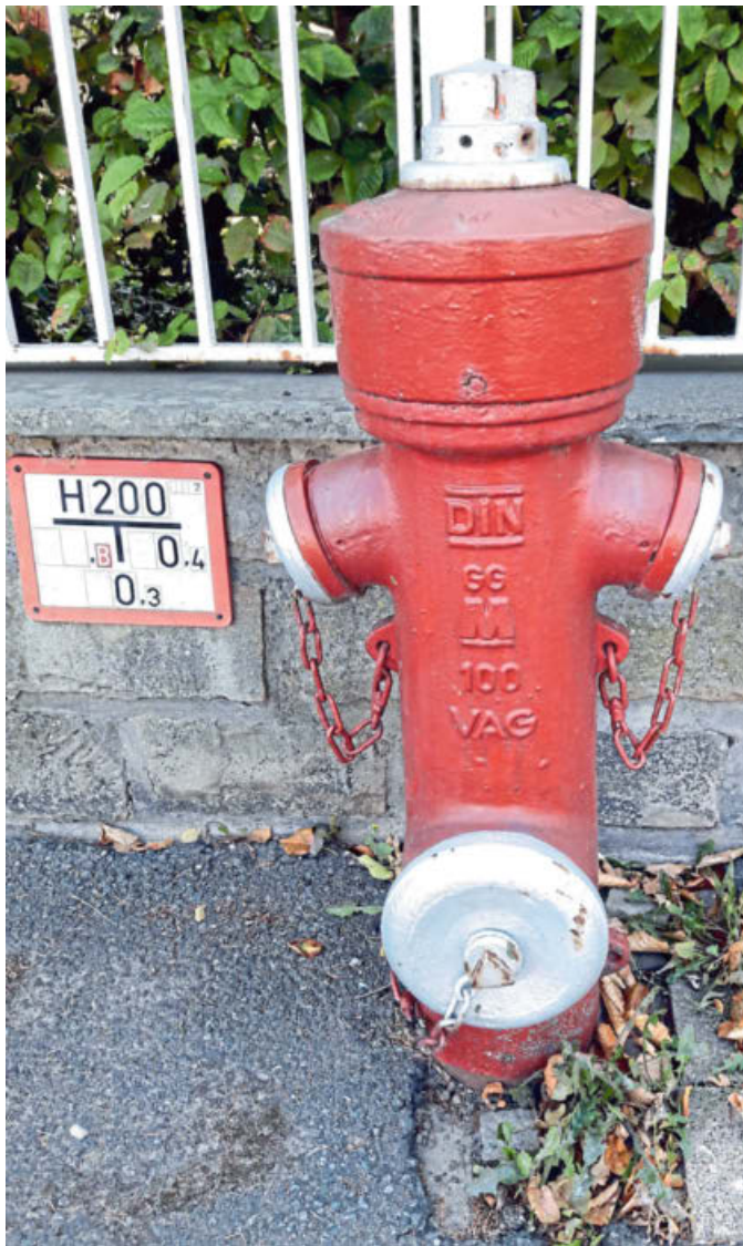
Roter Kamerad: Ein Bänder Überflurhydrant.
