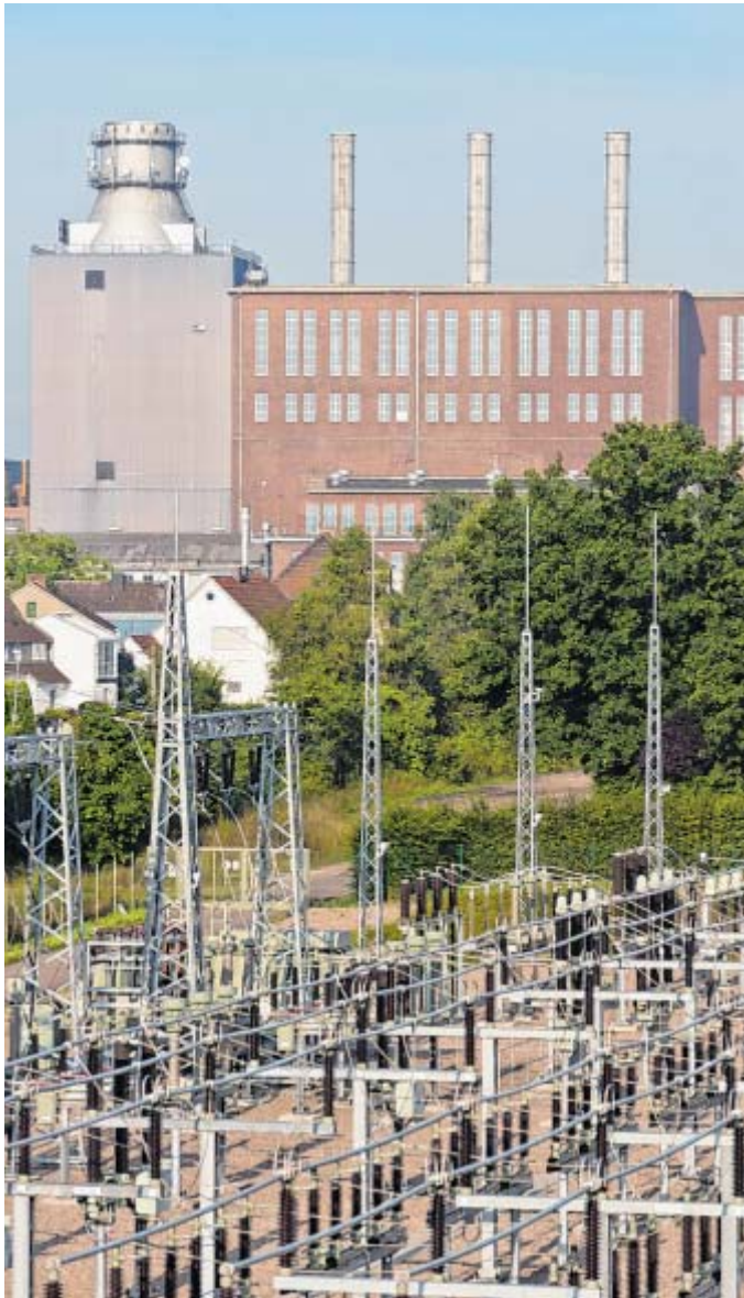
Stromversorgung: Das Kraftwerk Kirchlengern wurde immer wieder modernisiert.
